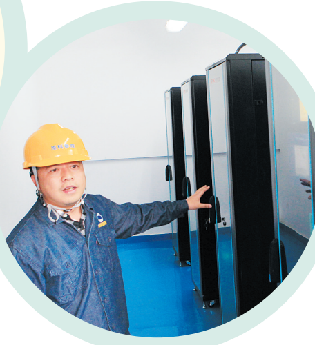
▼图为安装在珠海市金湾区企业内的VOCs在线监测仪器。
