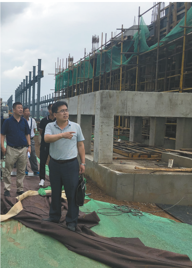
图为扬尘污染执法专项行动中,河北省生态环境厅环境执法人员现场检查建筑工地扬尘污染防治情况。 闫兆静摄
