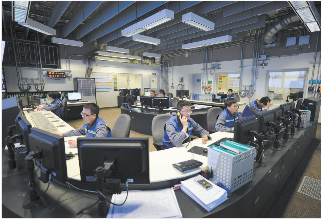
图为海阳核电2号机组主控室。
