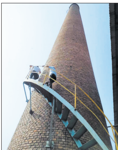
时间:2019年6月16日 地点:河南省安阳市某企业烟囱
