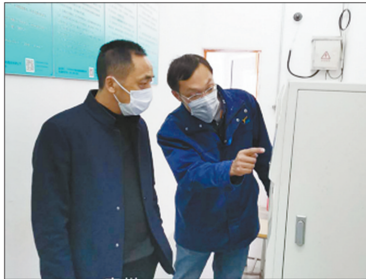
为加强疫情防控期间企业环境监管,江苏省泰州市泰兴生态环境局组织执法人员开展“双随机”执法检查。在泰兴金燕化学科技有限公司,执法人员对其存在的突发环境事件应急预案中无固废专章和污染防治设施专章、危废仓库未安装计量设施等问题现场提出整改意见,督促公司加强环境管理。图为执法人员全程佩戴口罩和执法记录仪在企业检查。
