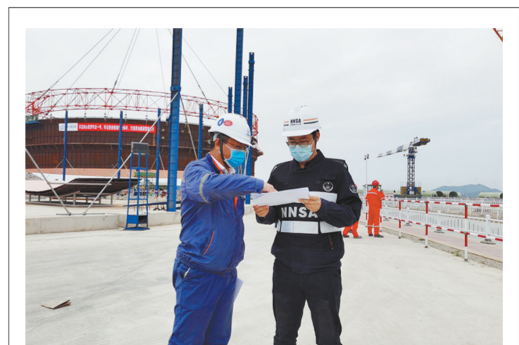
近日,福建省漳州核电厂1号机组衬砌里模块首次吊装顺利完成。生态环境部华东核与辐射安全监督站同时在线上线下审查施工方案、开展专题对话、见证吊装过程,取得了良好的监督效果。图为吊装监督现场。
