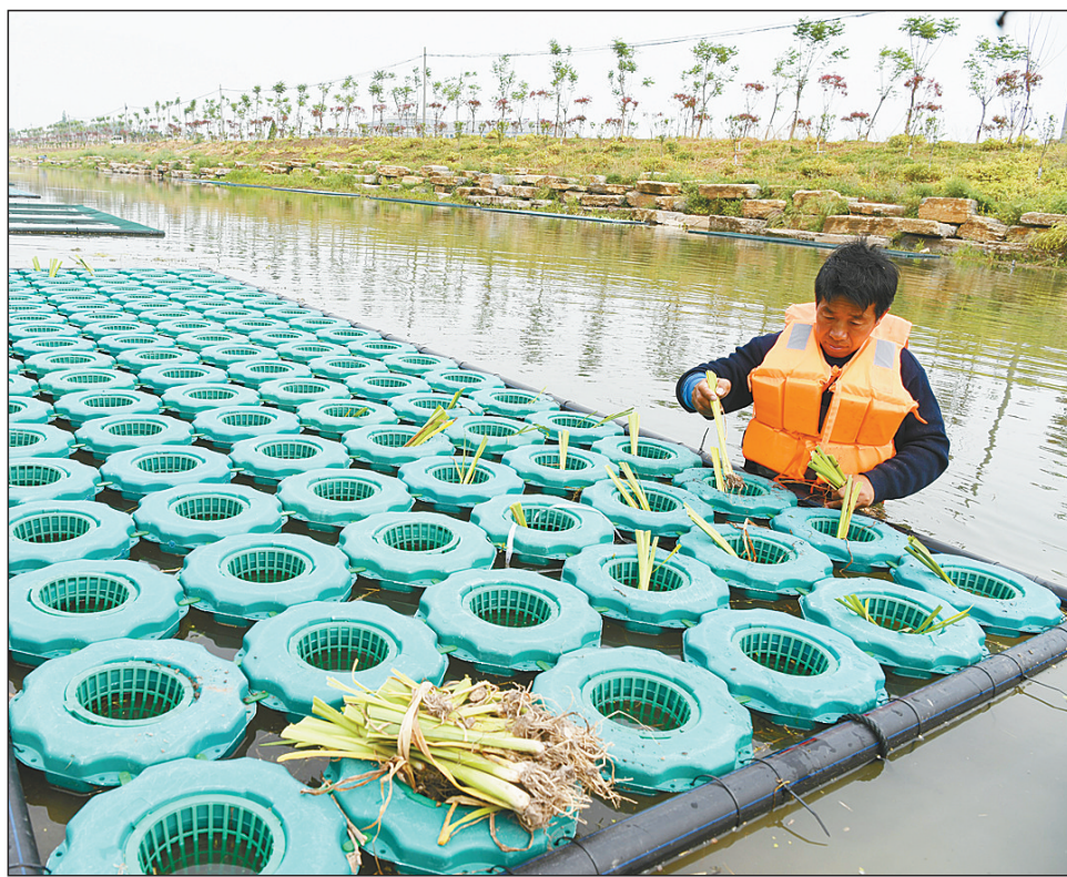
近日,江苏省淮安市洪泽区东双沟镇境内,工人在连接洪泽湖、白马湖的重要水系草泽河设置浮岛,栽植荷花、狐尾藻等水生植物,从而改善水质,创造良好的水环境。
