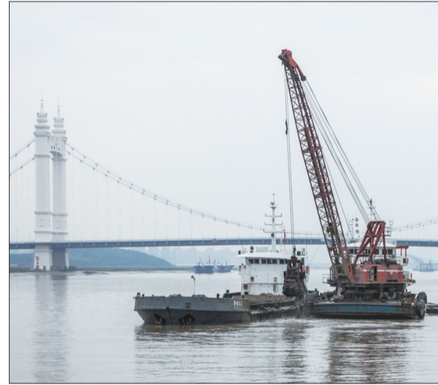
近日,一艘疏浚船正在浙江舟山中心渔港进行系统性的清淤、疏浚,进一步改善港口航运条件、港湾水质及生态环境质量,打造蓝色港湾。 人民图片网供图
