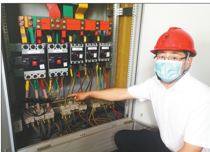
图为山东新丰肥业有限公司电力设备上安装的环保用电监管设施。 董若义摄
