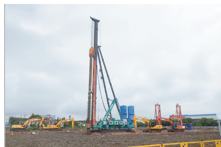
近日,上海市竹园污水处理厂四期工程正式开工。这一工程是上海市重大工程项目及苏州河环境综合整治四期工程的重要组成部分,总投资约100亿元。图为工程施工现场大型机械正在作业。蔡新华 丁波供图
