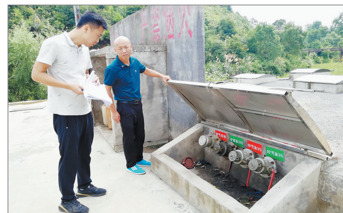
今年以来,江西省宜春市上高生态环境部门对全县所有重点排污单位和监管对象开展突出生态环境问题大排查行动,对排查发现的40余个问题分门别类系统推进整改,其中2个涉及大气污染防治领域加油站、储油库油气回收管理不规范问题,联动商业管理部门,督促相关企业落实整改。图为上高生态环境执法人员正在上甘山加油站督查油气回收整改情况。 冯国摄
