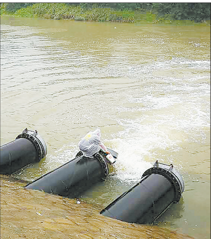
时间:7月11日 地点:江苏省南京市高淳区城西排污站
