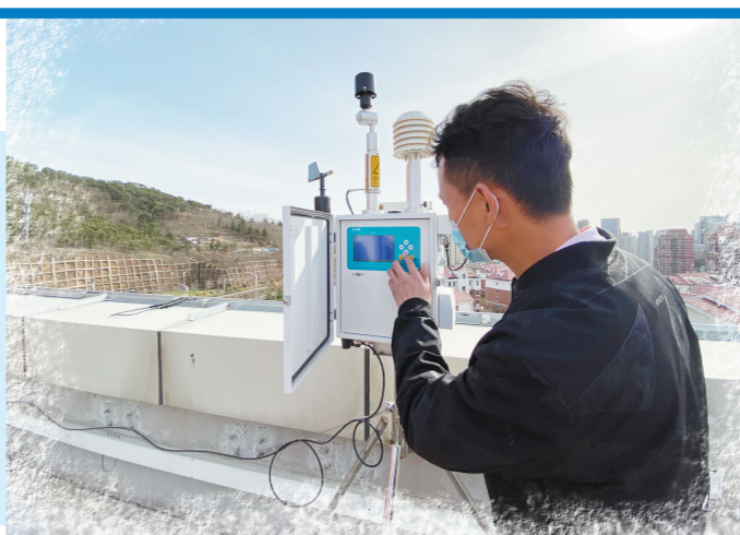
图为工作人员正在对镇街站设备运行情况进行检查。 青岛市生态环境局供图
