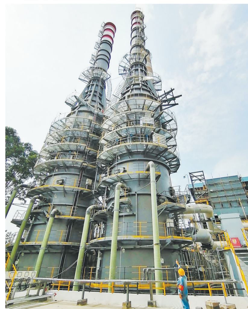
攀钢集团攀枝花钒钼有限公司能源动力分公司锅炉烟气脱硫脱硝项目成功建成投运。资料图片
