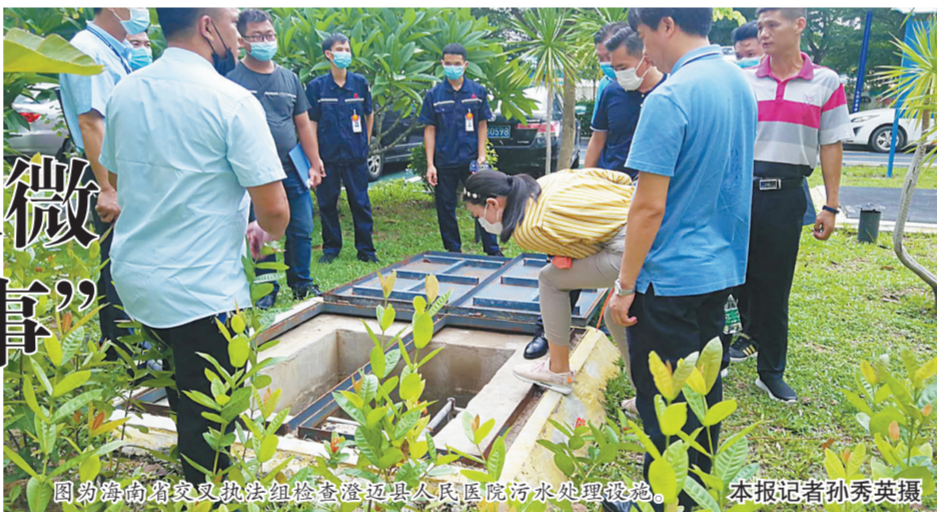
图为海南府交又执法组检查澄边县人民医院污水处理设施。 本报记者孙秀英摄
