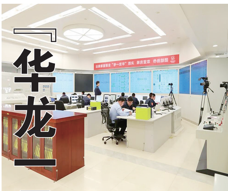
图为“华龙一号”首堆并网现场。过海东 郑欣摄
