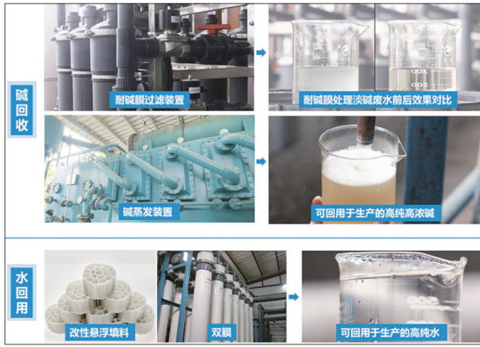
印染废水资源化示范工程
