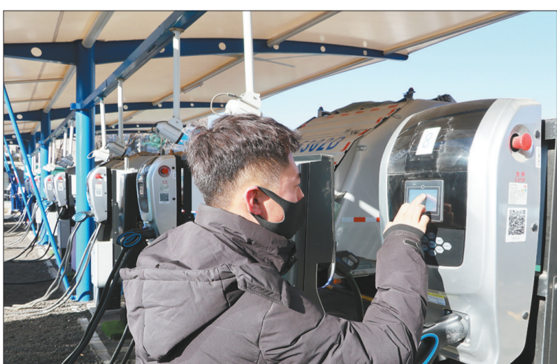
新投入运营的北京运营丹桥南侧宝隆广场特瓦特超级充电站。 邓佳摄
