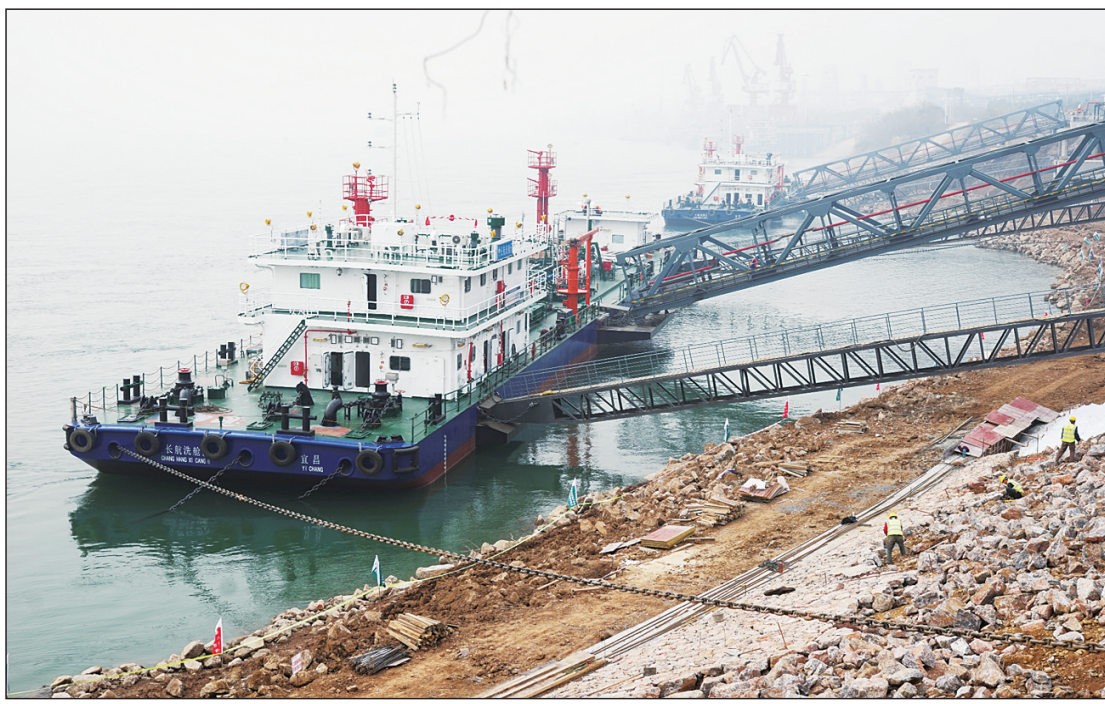
12月28日,湖北省宜昌市化学品船舶洗舱站竣工验收。这个船舶洗舱站是长江中上游建成的第一个化学品船舶洗舱站,可清洗包括苯类、醇类、酸类、碱类等多门类危化品,可同时满足两艘5000吨级船舶洗舱作业,洗舱能力达600艘次/年,污水处理量达500立方米/日,污水应急储罐能力为4万立方米,每年可接收处置化学品洗舱水及污染物15万吨。
