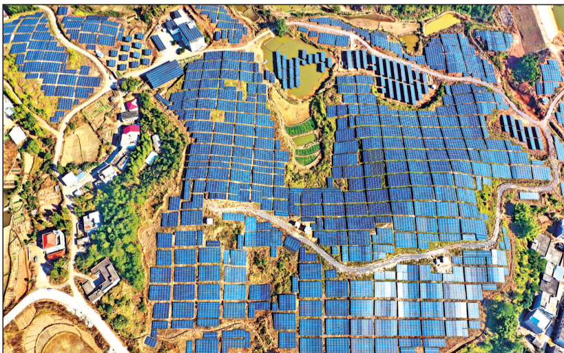
近年来,江西省赣州市会昌县因地制宜进行综合、立体、多层次开发光伏发电载体资源,探索沙光、农光、渔光等类型的“光伏+扶贫”项目,既为村集体带来了土地租金收入,又给村民提供了光伏发电企业就业岗位,实现土地增产、企业增效、农民增收。图为庄口镇黄沙村光伏扶贫电站。 人民图片网供图
