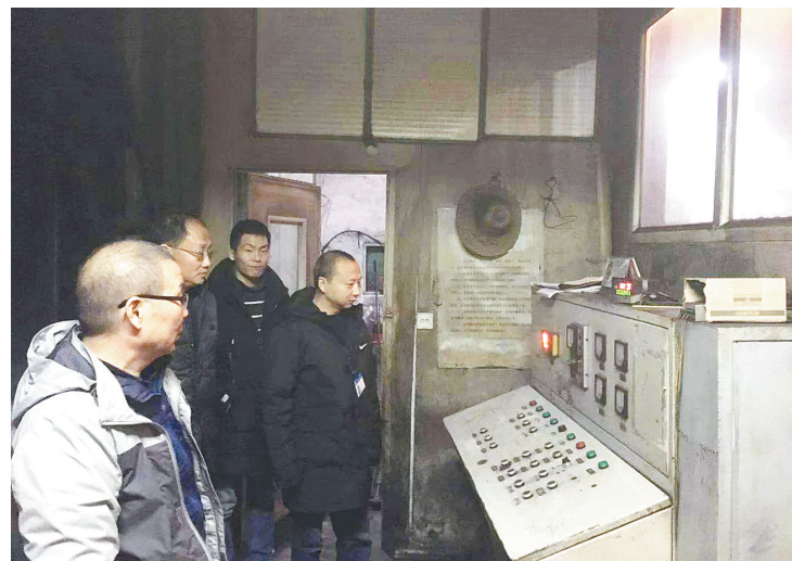
图为陕西省汉中市经开区生态环境执法人员对汉江药业锅炉运行情况开展夜间巡查检查。
