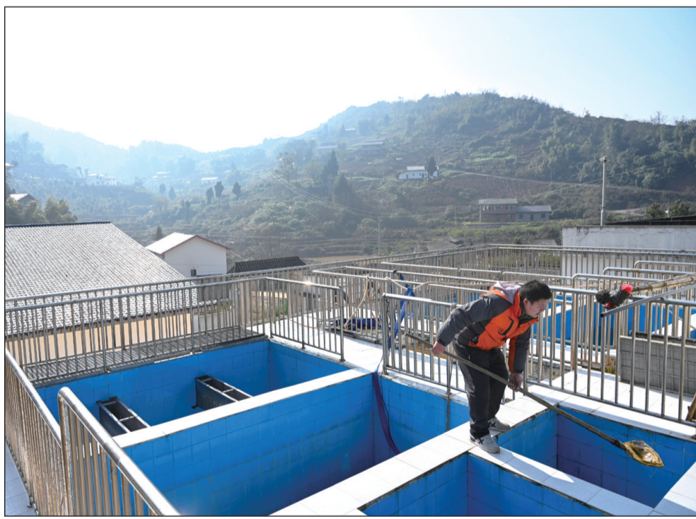
近年来,重庆市渝北区大力实施农村饮用水安全提升工程,加快补齐农村供水基础设施短板,完善供水设施条件。2020年该区改造新建洛碛、茨竹等片区水厂9个,改造和新增供水管网111公里,巩固提升农村26万人饮水安全。图为渝北区大盛镇顺龙村水厂,工作人员每天定时清理沉渣池底。 人民图片网供图
