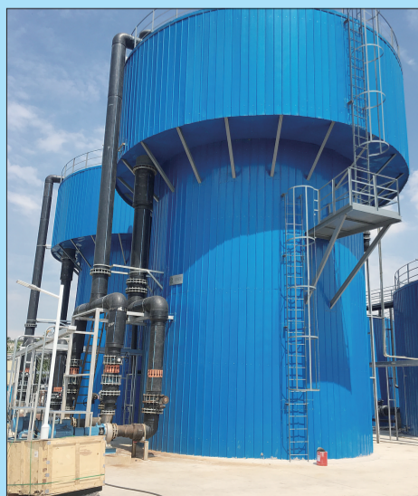
CIMBR好氧环流喷射膜生物反应装置推广工程
