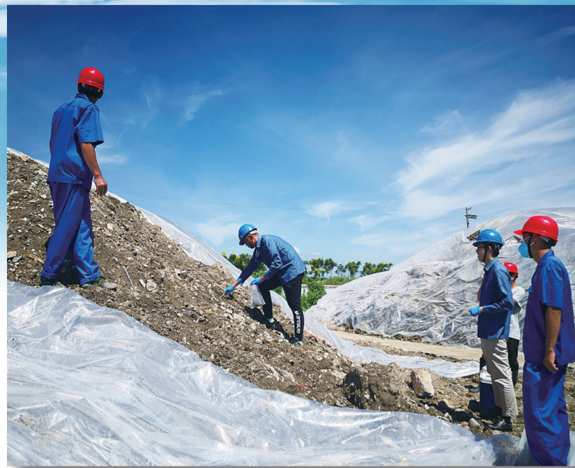
图为台州温岭市泽国镇受污染耕地重金属原位钝化修复示范工程。台州市生态环境局供图
