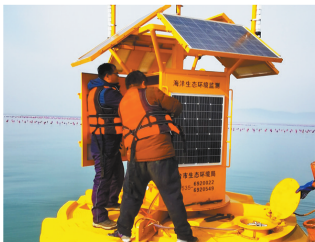
山东省烟台市生态环境局日前在渤海区域陆续投放14套海洋生态环境在线监测系统,对海洋保护区、风景旅游区、养殖区等重点海洋功能区水质状况实施全天候实时监测。图为工作人员登上在线监测标体调试设备。董若义 谢楠摄
