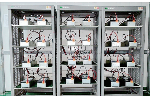
丰田-格林美动力电池梯级利用储能项目
