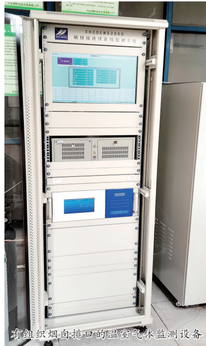
有组织烟道排口的温室气体监测设备
