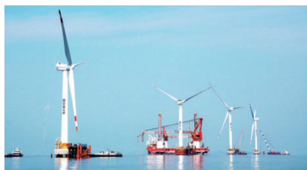
三峡能源“福清兴化湾样机试验风场”项目
