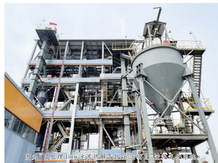
图为“日处理100t污泥热解气化示范项目”污泥气化系统。
