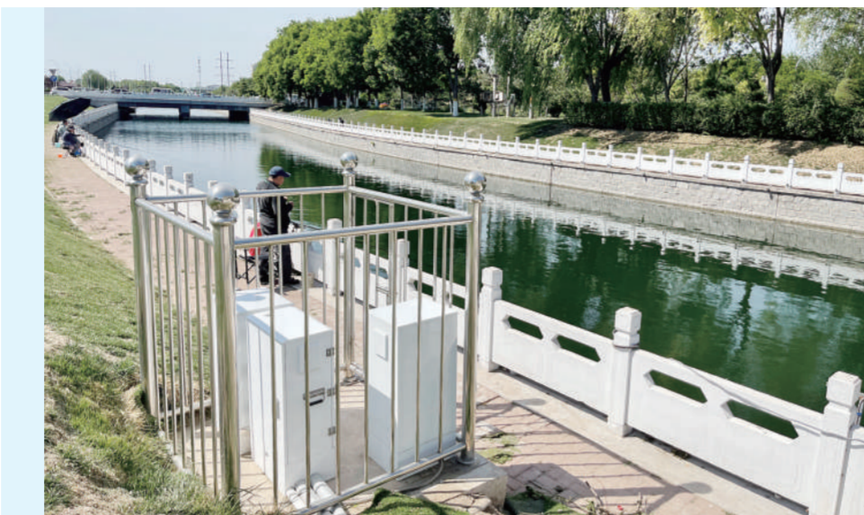
北京市丰台区生态环境局布控的高密度水环境自动监测微站,实现区域重点水河道水质指标24小时监测,结合水质超标溯源报警功能,能够及时报警超标原因,支持河道排水口的精细化管理,保障水生态环境质量,为水生态的长效提升夯实基础。 王荣摄
