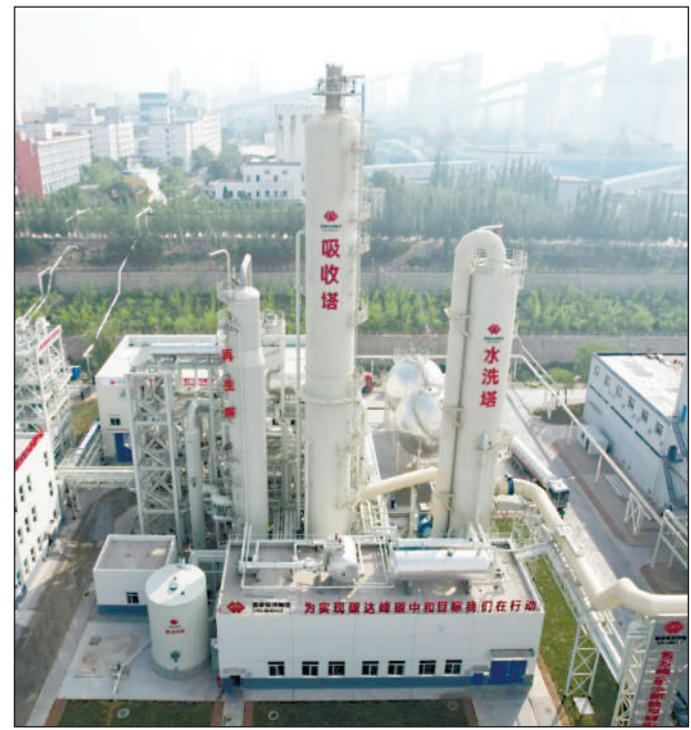
图为15万吨/年CCS示范工程
