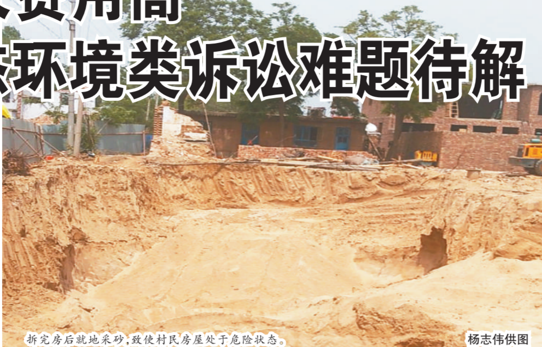
拆完房后就地采砂,致使村民房屋处于危险状态。
