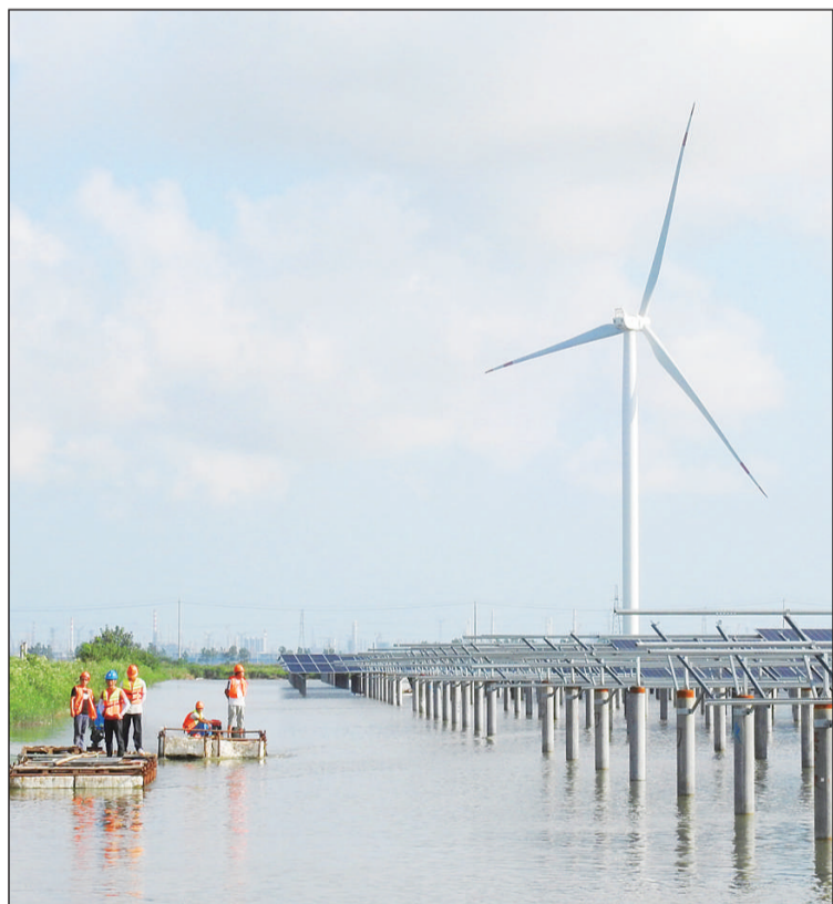
近日,在江苏省连云港市灌云县洋桥200兆瓦“渔光一体”光伏发电项目工程现场,工人正在加紧进行设备安装施工。洋桥“渔光一体”光伏发电项目是国内第一批光伏平价上网示范项目之一,占地3500亩,装机容量200兆瓦,与千亩鱼塘相生相伴,形成“上可发电、下可养殖”的渔光一体光伏发电系统,建成投运后将为当地村民就业和村集体增收致富提供新的合作路径,助力农业转型升级和乡村振兴。
