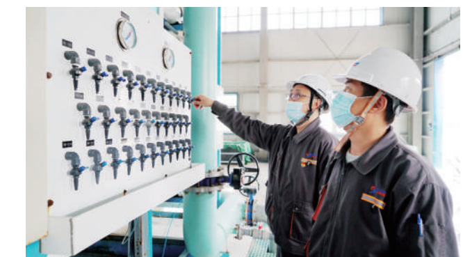
燕山威立雅公司员工精心操作,确保污水处理装置高效运行。 钱江摄
