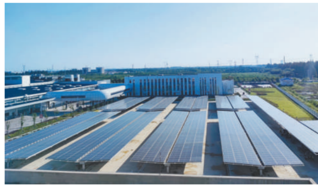
图为蒙牛武汉工厂太阳能光伏发电项目。
