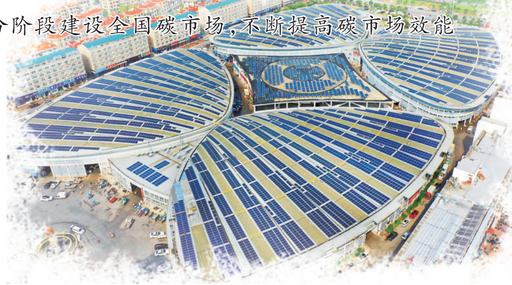
▲图为浙江某地扇贝型屋顶光伏电站。 人民图片网供图
