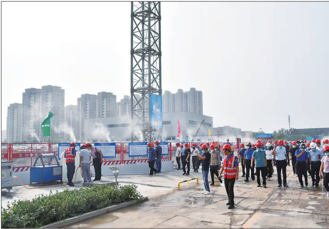
日前,山东省滨州市生态环境局联合市城管局、住建局等多部门,组织工作人员现场观摩主城区在建工地扬尘治理先进做法,提升各部门在建工地扬尘治理防治水平。图为在滨州市全民健康文化中心项目施工现场,大家仔细观摩了解工地扬尘管理、高砼车辆和建筑垃圾运输车辆清洗等情况。
