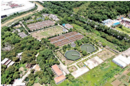
为耗电和污泥;无动力内循环,实现超低能耗;抗冲击能力强;池体采用防腐防锈的碳钢、304不锈钢材质以保证使用寿命。
