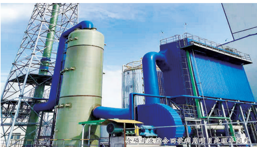
含磷母液综合回收利用项目处理车间外
