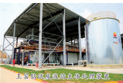
王窑钻试废液站主体处理装置
