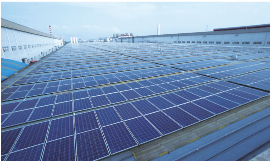
合肥光伏屋顶光伏玻璃
