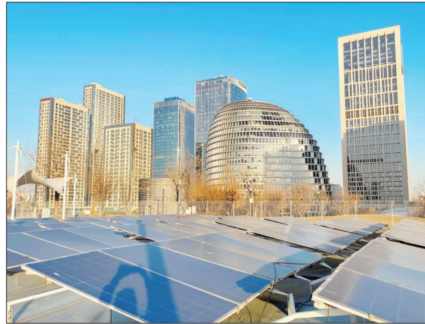
场馆建设和能源供应是北京冬奥会成功举办的重要基础和保障，同时也是碳排放控制的重点领域。北京冬奥组委与北京市政府、河北省政府紧密合作，形成合力，各项措施落实到位，其中全部场馆实现可再生能源利用，所有场馆100%使用绿色电力。图为北京冬奥村光伏发电场。
