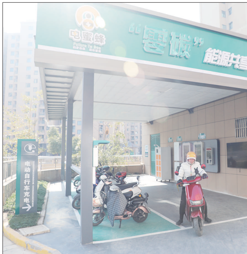
近日,江苏省内首座社区电力组合站所——“零碳能源共享e站”在无锡市新吴区新安佳苑投入运行。这个站所集风、光、充、换、储、建筑节能、气象预测、周边照明、视频监控、运维监测、线损治理等11项功能于一体,“零碳”成果普惠到社区居民。
