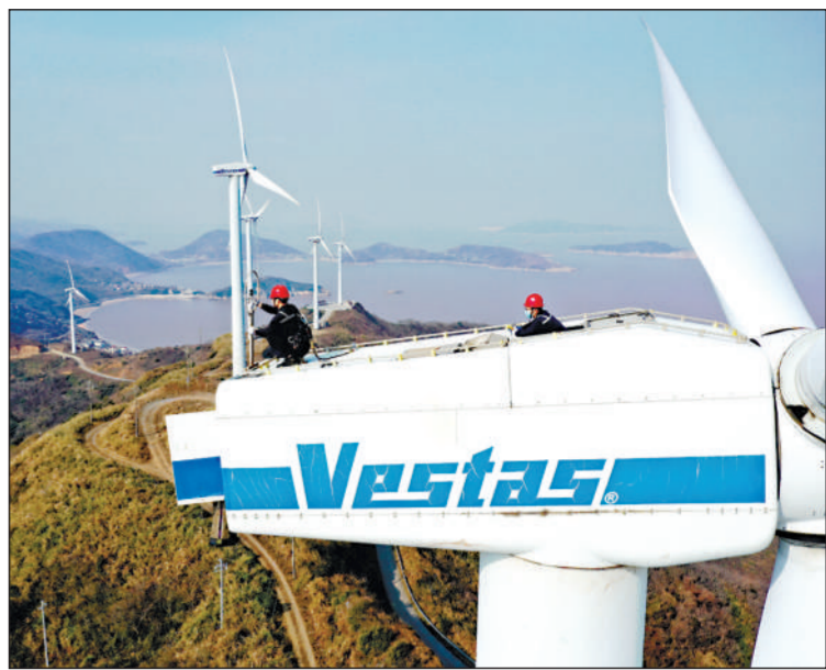
近日,在浙江省舟山市岱山县大衢岛赛丽新能源风电11号机组的机舱上,工人正在进行例行检查,以保障机组运行安全。据了解,浙江赛丽新能源有限公司在岱山县大衢岛上共建有59台风机机组,2021年共发电1.44亿千瓦时,可节约标准煤5.76万吨,减少CO 2 排放14.36万吨。
