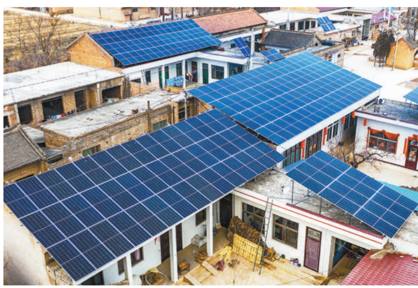
山西省运城市芮城县陌南镇庄上村是一个地处黄河北岸的古村落。近年来,庄上村因地制宜,运用“光储直柔”新技术,大力发展绿色清洁能源。目前,全村72户用上了“光储直柔”村级发电系统,实现村级五台并网变压器的首台400kW并网发电,被农业部列为“中国零碳村镇促进项目”示范村。 人民图片网供图
