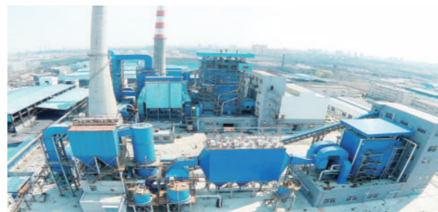
图为克州聚源热电有限责任公司58MW角管式(链条)锅炉烟气同时脱硫脱硝除尘工程。
