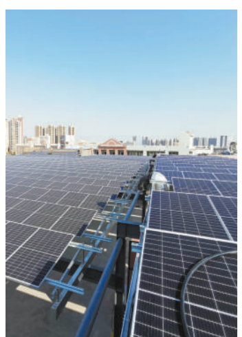
深圳大兴丰田雷克萨斯汽车经销商光伏发电站
