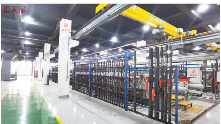
福天宝电镀废水零排放水厂净水系统
