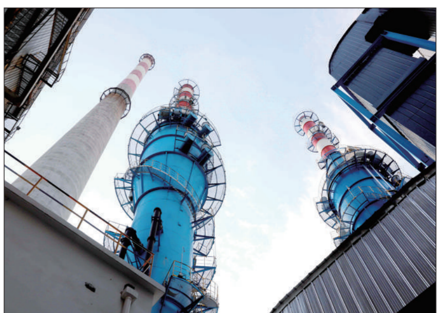
烟气脱硫脱硝设施。
