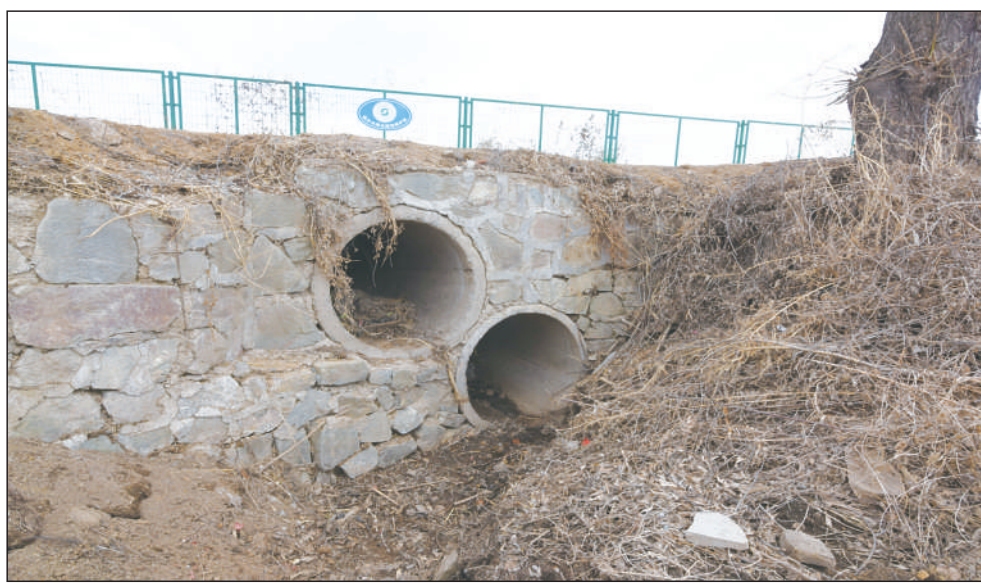
我国城市地下管道规模巨大。现实中,一些地方的排水管道成为城市黑臭水体产生的“诱因”之一。 本报记者邓佳摄
