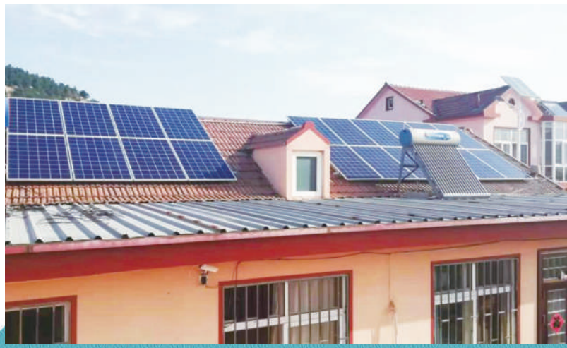
乐家村“零碳供暖”设施。力诺瑞特新能源有限公司供图
